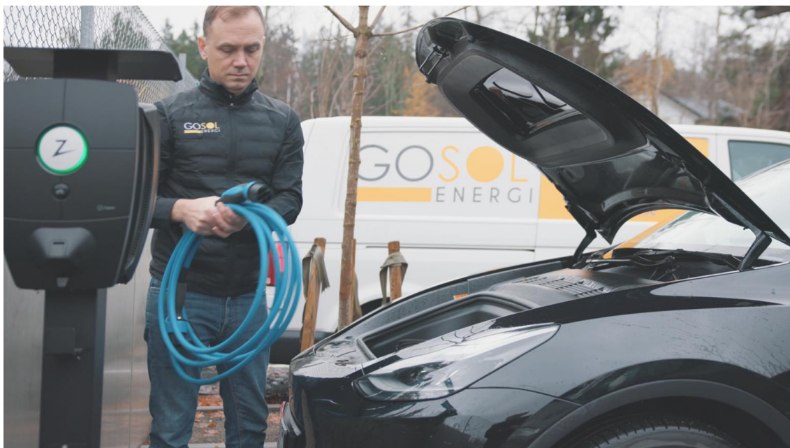
Fotografi 4. Av Bolaget installerad ladd-infrastruktur med fabrikat Zaptec Pro
